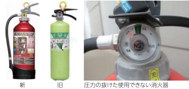
新 旧 圧力の抜けた使用できない消火器
